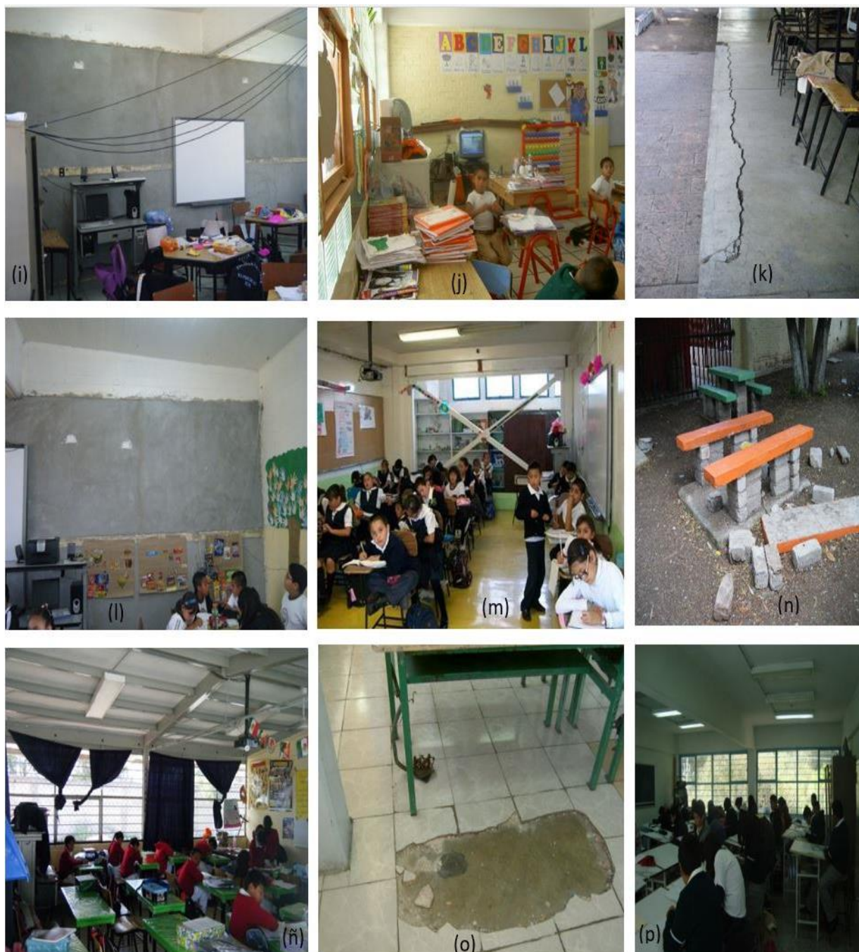
Figura 15. Condiciones de los espacios educativos para impartir clases tanto a nivel de educación primaria como secundaria. Imágenes (i), (l) y (m) de Hidalgo; imágenes (j), (ñ), (o) y (p) de la Ciudad de México; imágenes (k) y (n) de Tlaxcala.
