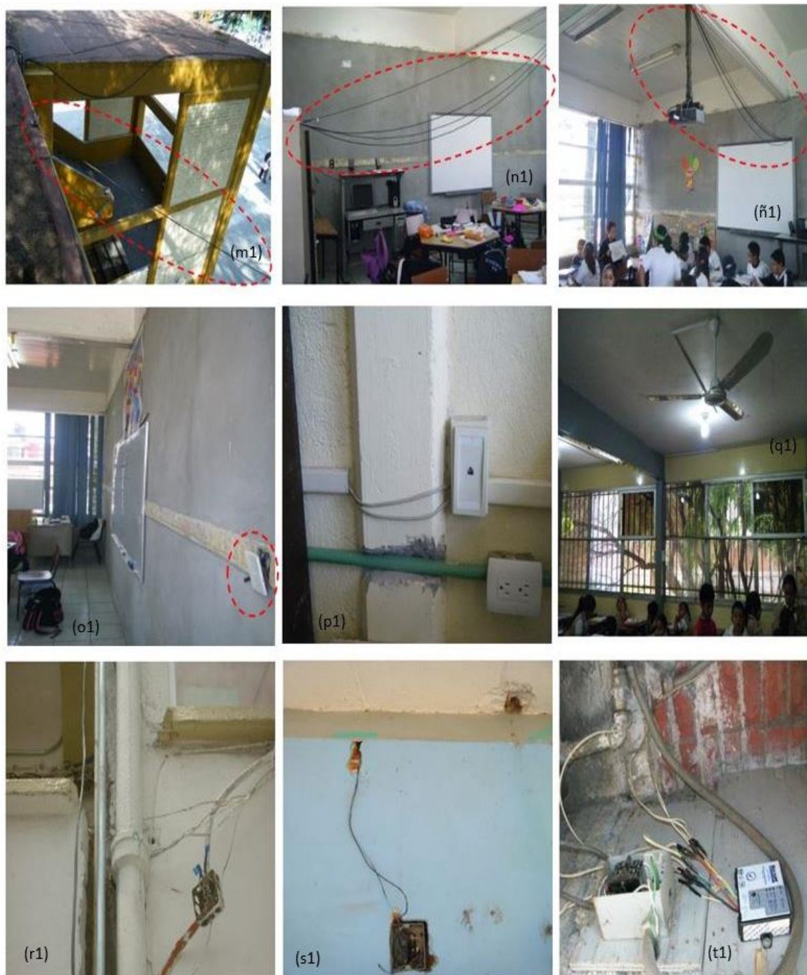
Figura 18. Carencia total del mantenimiento eléctrico en las instalaciones tanto en educación primaria como en secundaria. Imágenes (m1), (o1), (p1) de Hidalgo, imágenes (n1), (r1), (s1), (t1) de la Ciudad de México, e imágenes (ñ1), (q1) de Tlaxcala.
